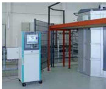
Центральная панель управления, оборудованная ПК
