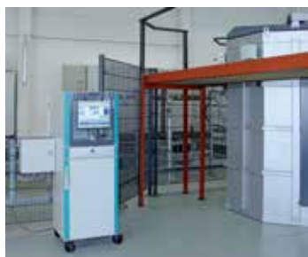
Центральная панель управления, оборудованная ПК
