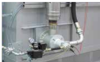
Подвод газа на боковой стороне печи
