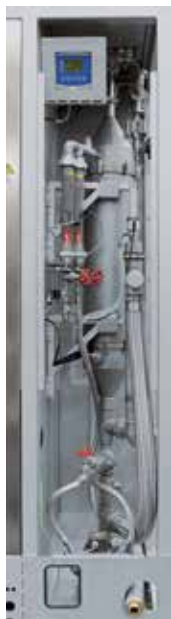
Система очистки технологических газов методом промывки
