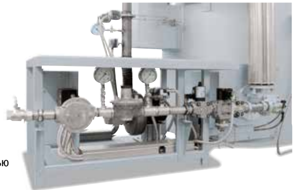
Горелка с газовым оборудованием
