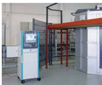
Центральная панель управления, оборудованная ПК
