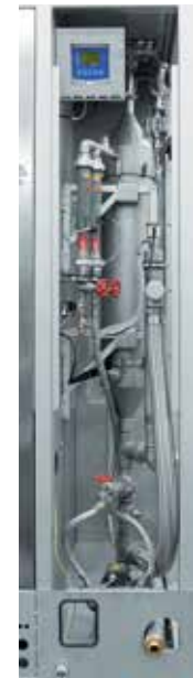
Система очистки технологических газов методом промывки
