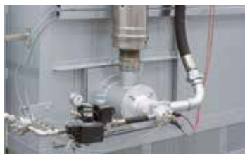
Подвод газа на боковой стороне печи
