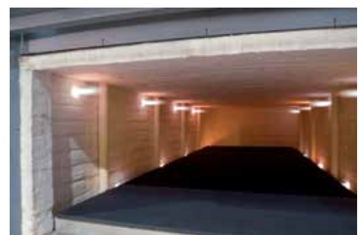
Внутреннее пространство печи с восемью горелками сверхбыстрого сжигания
