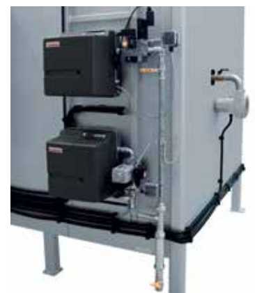
Газовая горелка для отопления печи и термического дожигания
