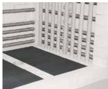
Вдувание предварительно нагретого воздуха через перфорированные трубки
