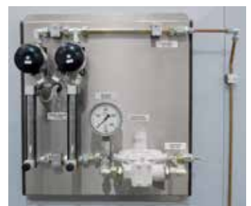
Система подачи негорючих защитных или реакционных газов
