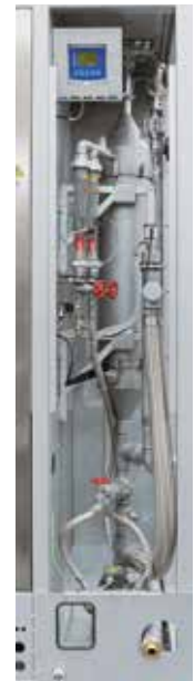
Система очистки технологических газов методом промывки
